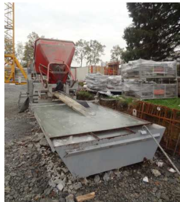
Système de récupération des laitances de béton
